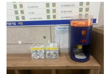
공장 내 귀마개 디스펜서 설치
